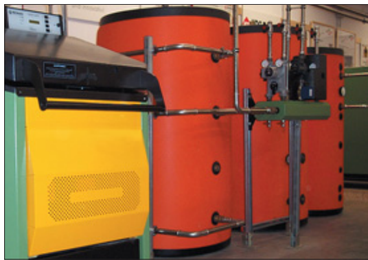
Abb. 10: Scheitholzkessel mit Pufferspeicher
